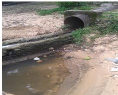
Figura 2: Tubulação de Rede de drenagem de água pluvial
